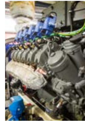
Drie nieuwe warmtekrachtkoppelingen met een totaal vermogen van 1500 kWh werden geplaatst
